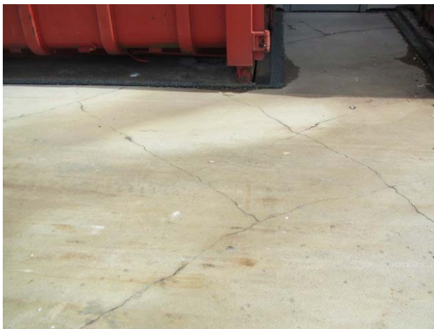
Foto: Voorbeeld niet-vloeistofdichte voorziening (scheuren).
