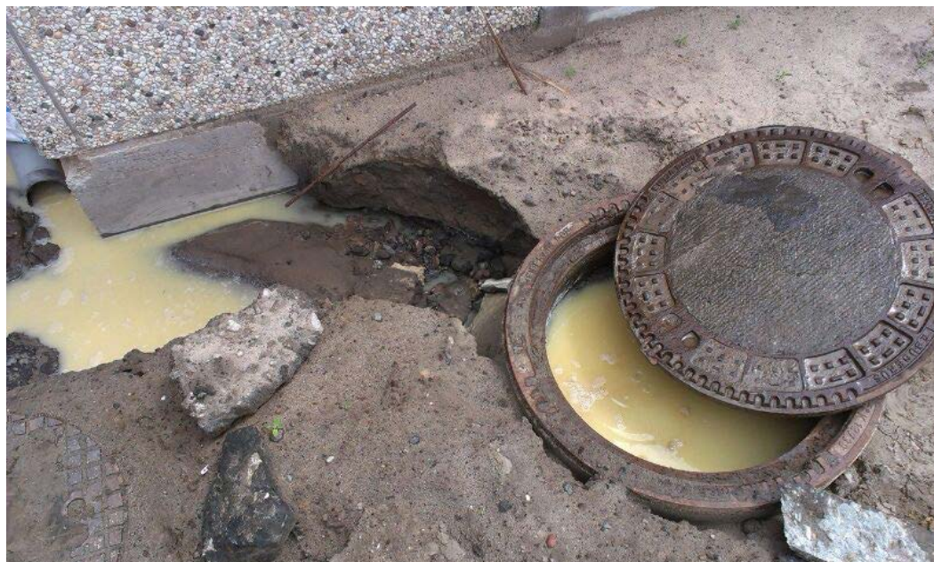
Foto: Verzakking in het rioleringsysteem.
